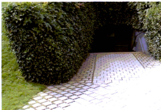
Ryc. 19. Zwiększanie odstępów pomiędzy kostkami w strefach skrajni ciągów komunikacyjnych jest sposobem na zwiększanie przepuszczalności nawierzchni. Fot. Ł. Dworniczak.
