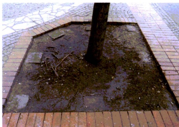
Ryc. 38. Zdegradowane podłoże w obrębie misy korzeniowej. Fot. M. Motas.
